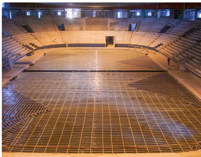
Instalace topných smyček na podkladní beton za využití fixační hřebíkové lišty IVAR.WL
